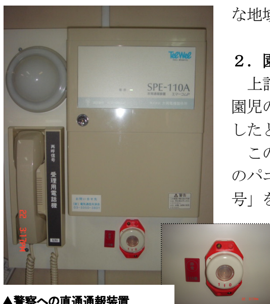
▲警察への直通通報装置
