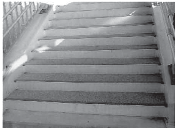
図14 段鼻が目立つゴムチップ舗装、二段手すりを設けた階段 (横浜市笹下歩道橋)
