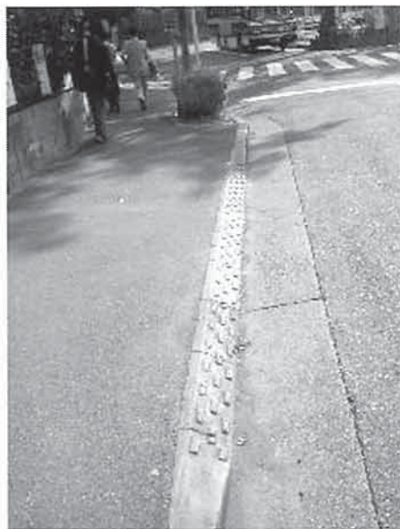
図 1 6 すりつけ部に段差 と注意喚起色
