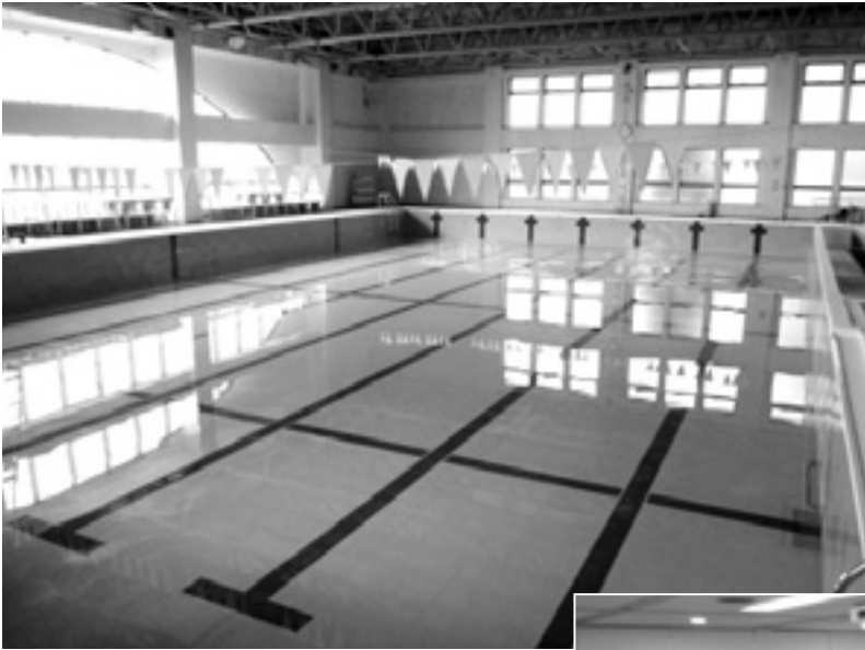
ふれあい健康増進センター 補修後の温水プール
