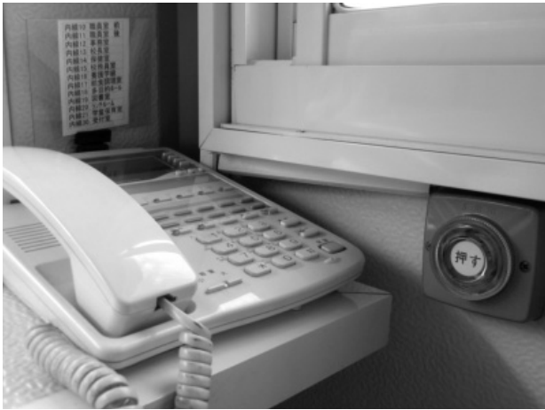
非常通報装置
